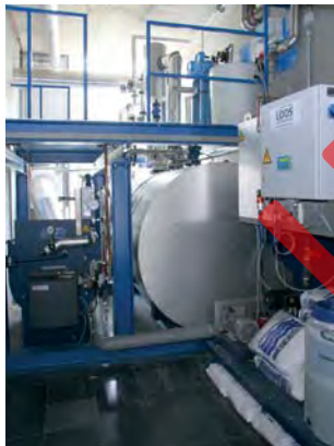
Abbildung 126: Dampferzeuger der Fa. Loos am FRAUNHOFER IFAM (COPYRIGHT) in Bremen
